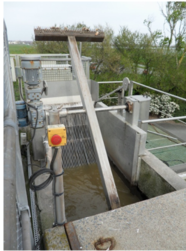
Figure 2: Etape de dégrillage
